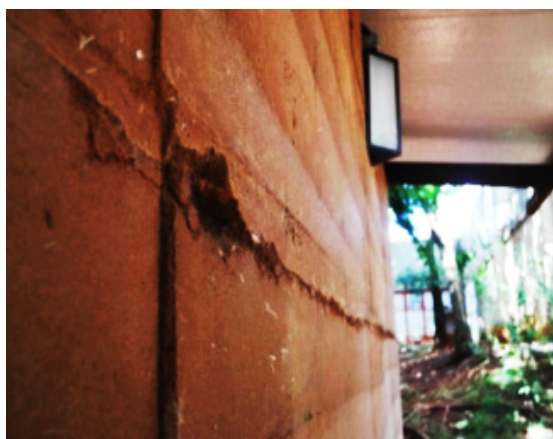
(b) desagregação entre camadas
