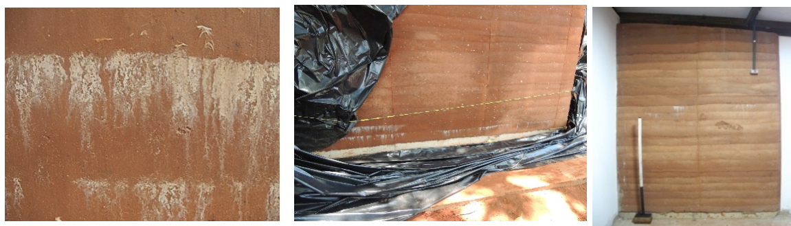
Figura 42: Manchas de eflorescências nas paredes de taipa.
