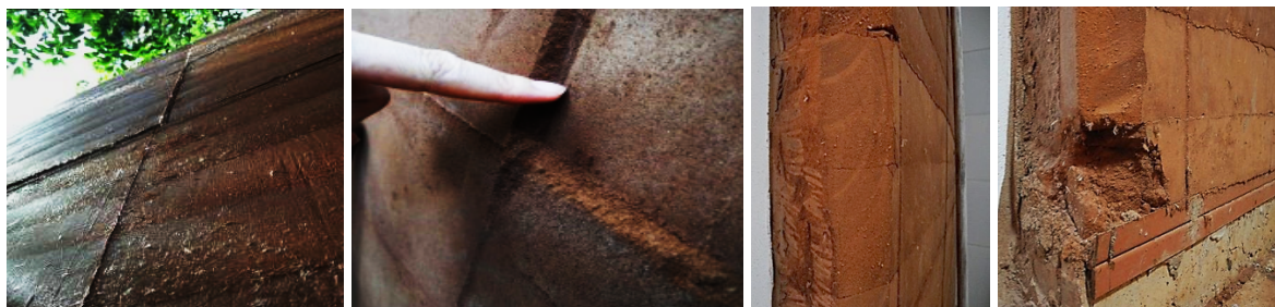
Figura 40: Marcas de cortes e defeitos de nivelamento da superfície da parede.
