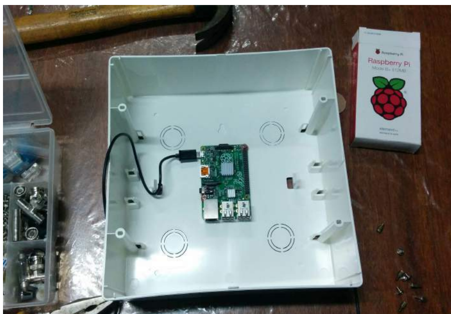
Figura 3.15: Raspberry Pi fixado na caixa de passagem.
