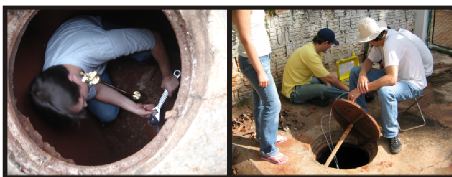
Figura 5.31 - Ponto de monitoramento de vazão.
