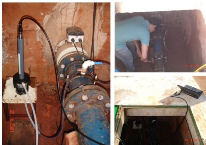
Figura 5.10 - Ponto de instalação - Sonda 1.
