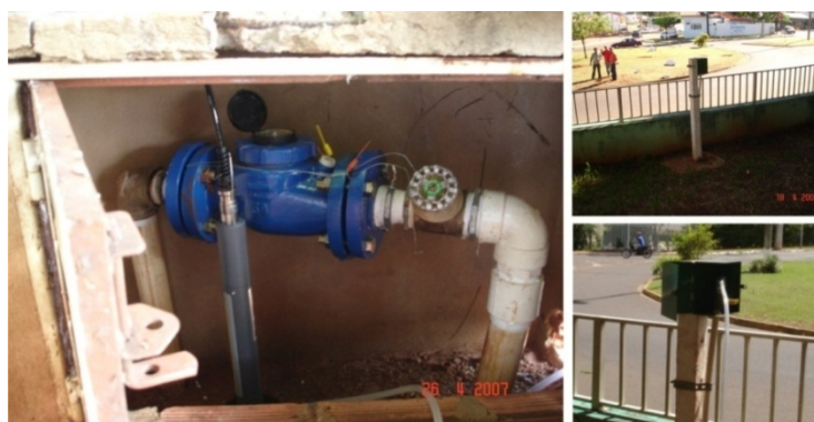
Figura 5.11 - Ponto de instalação - Sonda 2.
