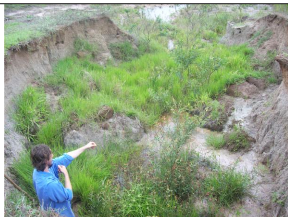
Figura 53 – Voçoroca com grande entalhamento já atingindo o lençol freático, avançando em direção a estrada rural.
