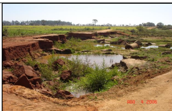
Figura 29 – Rompimento de ponte sobre o córrego Bom Jardim, provocada pela cheia de 2006.
