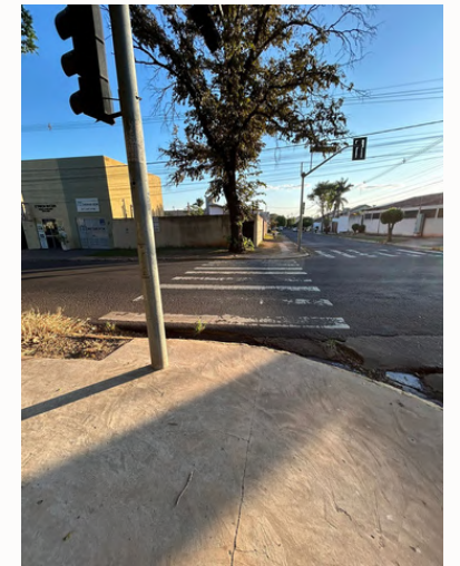
Figura 30: Falta de rampa na esquina
