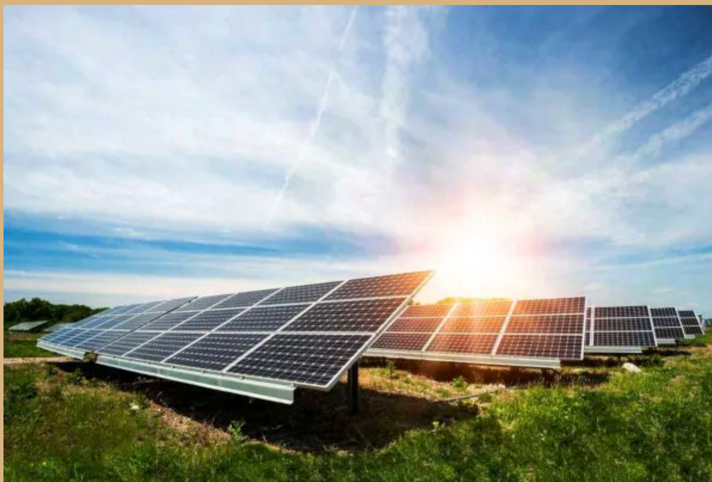
Figura 70: Painéis solares instalados. Fonte:
