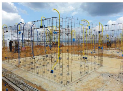
Figura 7 – Rede elétrica no sistema parede de concreto
