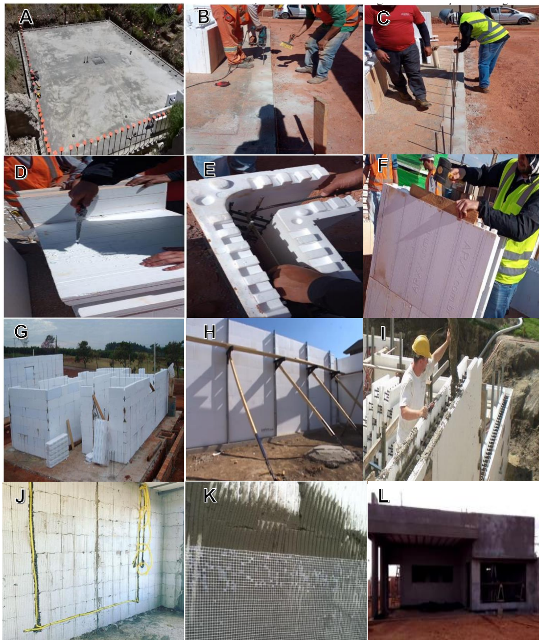
Figura 12 - Processo de execução e utilização de alguns materiais do sistema construtivo; (A) fundação radier; (B) perfuração da base para os arranques; (C) locação dos vergalhões; (D) recortes para esquadrias; (E) posicionamento dos aços nos blocos; (F) ajuste dos blocos; (G) Montagem das fôrmas formando a parede; (H) travamento das paredes; (I) concretagem (J) instalações elétricas; (K) chapisco com aplicação da tela de poliéster; (L) aplicação do reboco.
