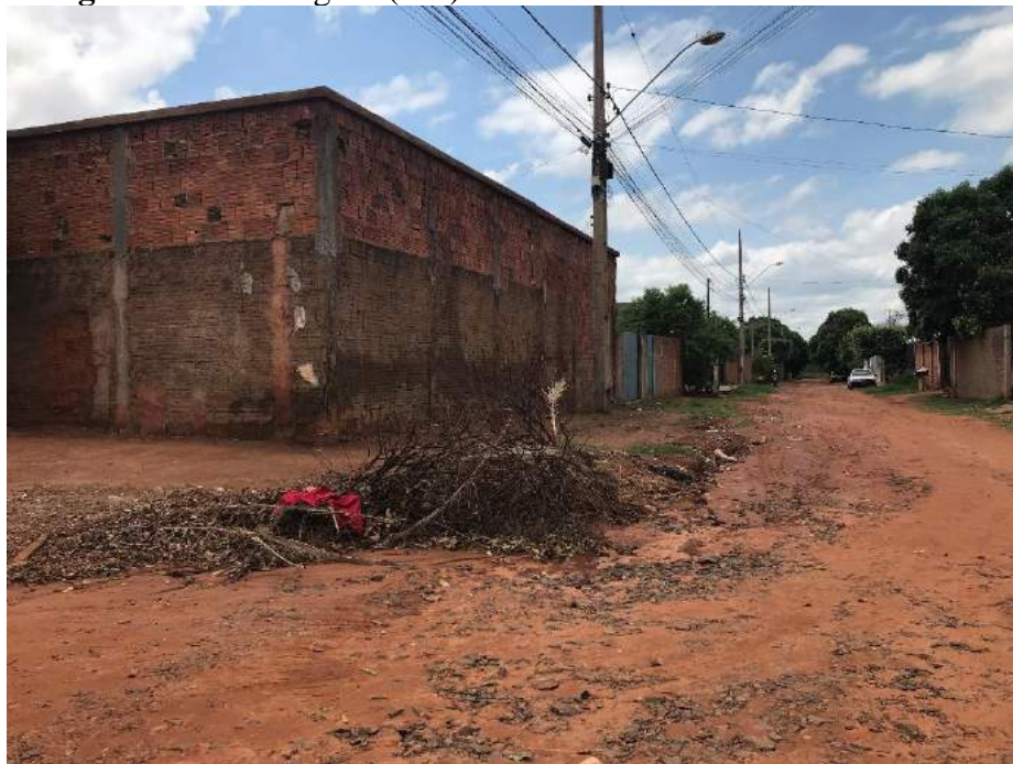
Imagem 17: Três Lagoas (MS): casas com ausência de reboco externo
