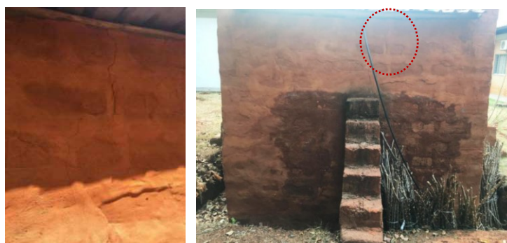
Figura 65. Trincas maiores que 2,0 mm.
