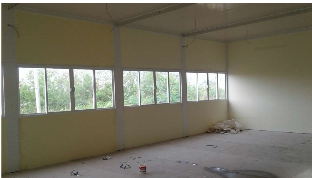
Figura 26 - Interior sala modular IFMS Campo Grande
