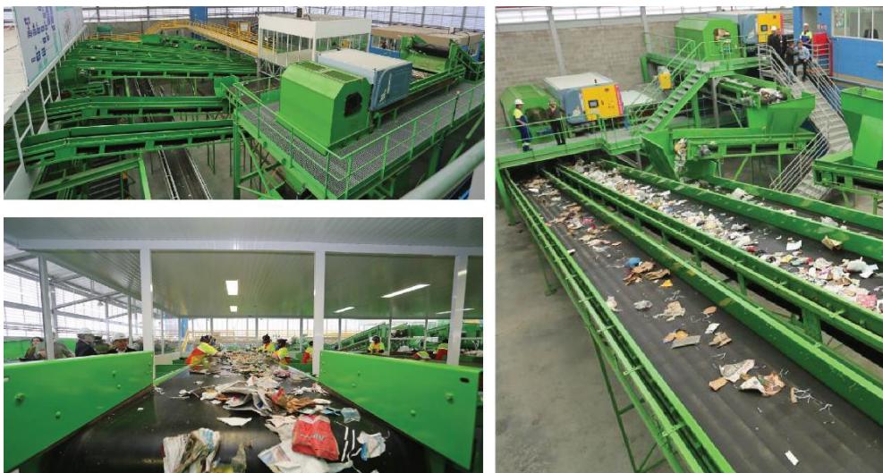
Figura 9: Vistas internas da central mecanizada Carolina Maria de Jesus
