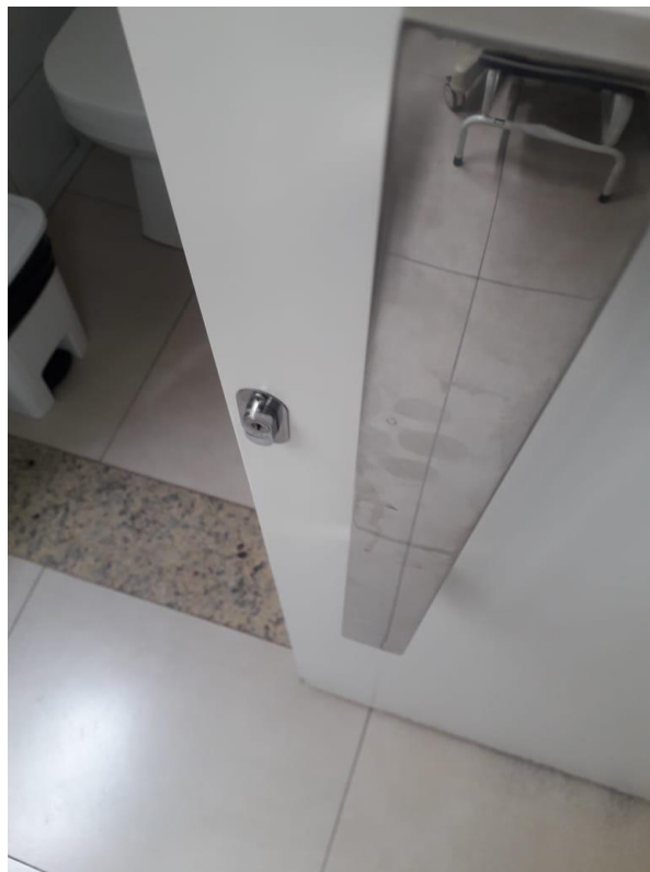
Figura 3. Maçaneta do banheiro.
