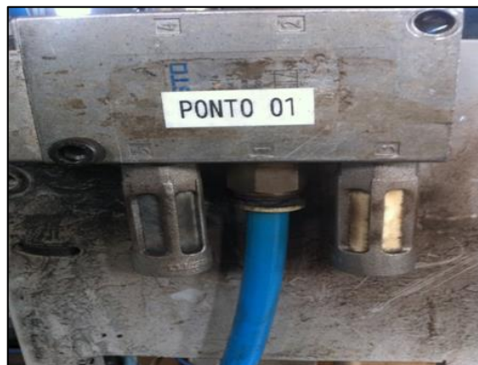
Figura 49 - Ponto de vazamento 01.
