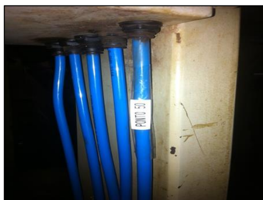
Figura 50 - Ponto de vazamento 50.
