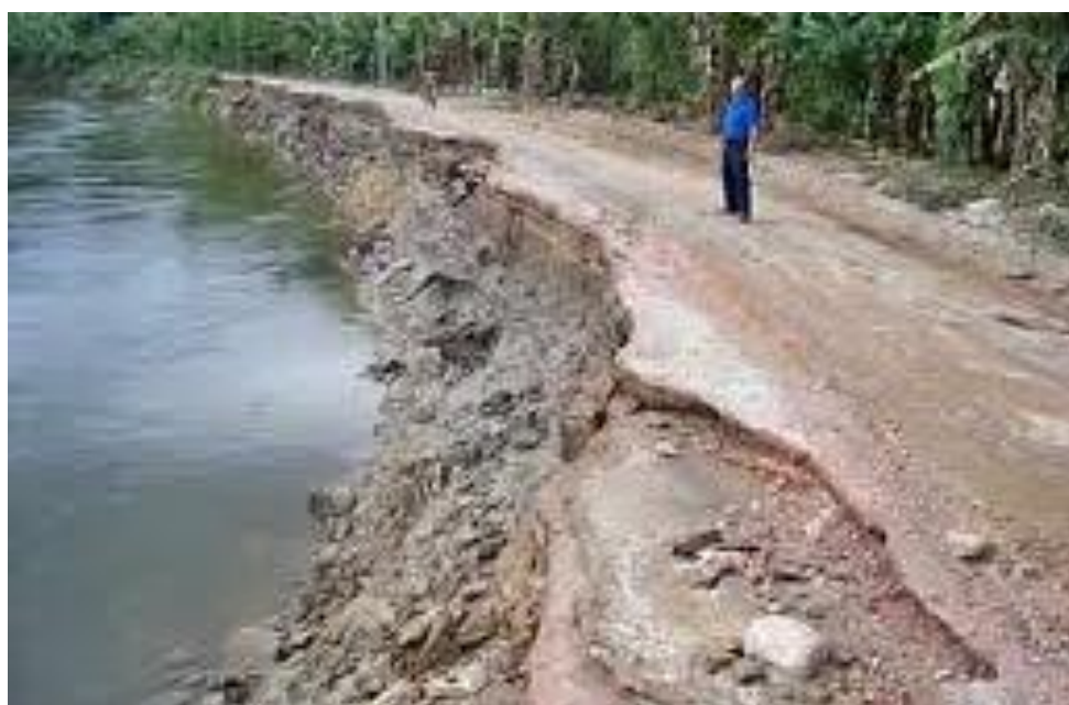
Figura 19 - Construção de estradas em locais inadequados. Fonte: meioambiente.culturamix.com.br (2014)
