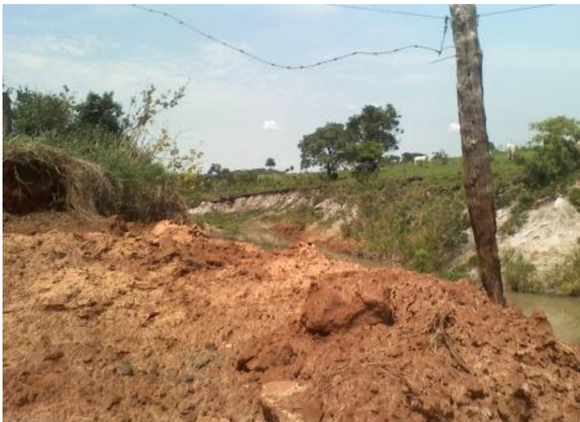
Figura 20 - Desbarrancamento do córrego. Fonte: Autor
