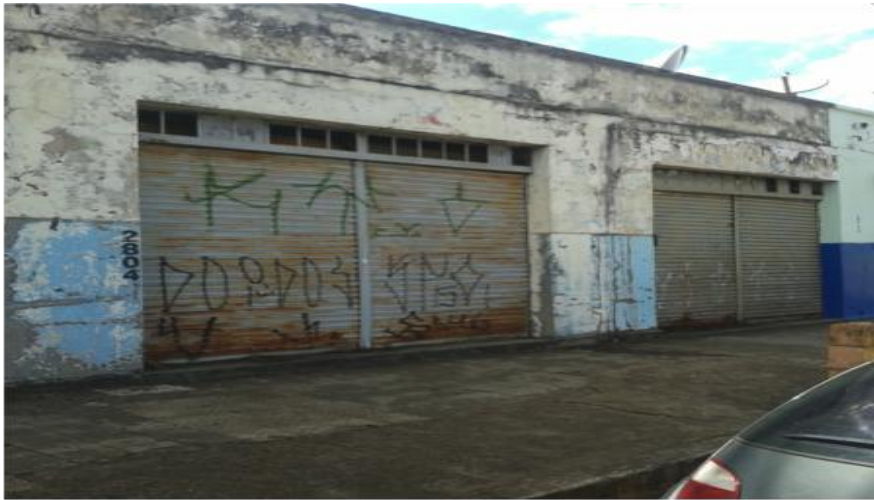
Foto 16 - Edifício em estado de abandono Fonte: Autor, 2016.
