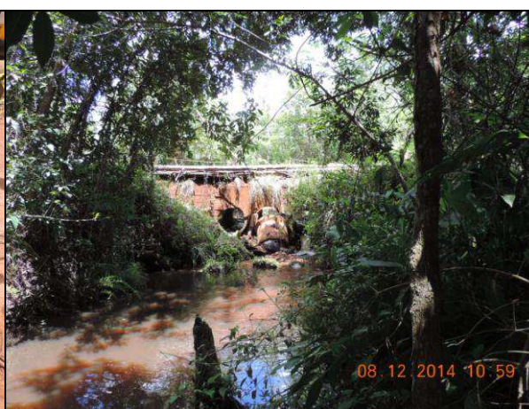
Figura 77: Médio curso da BHCM, ponto 5, desmoronamento da Ponte, a montante do ponto.
