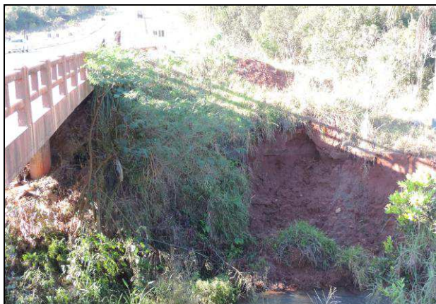
Figura 141: Médio/Baixo curso da BHCM, falta de manutenção da rodovia MS-395 acabou intensificando a erosão na margem esquerda do córrego Moeda.
