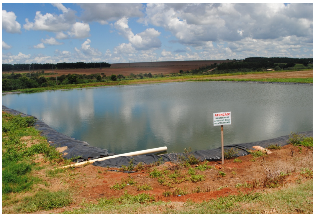
Figura 33 - Lagoa de decantação.
