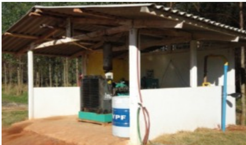
Figura 46 - Motor a biogás da UPL COOASGO.
