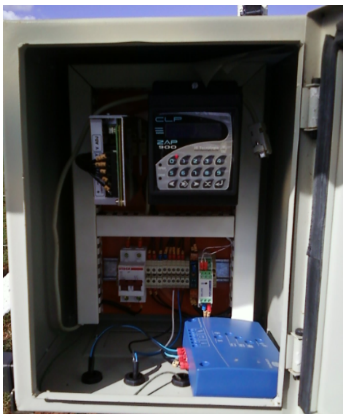
Figura 52 - Estação homologada de medição de gás.
