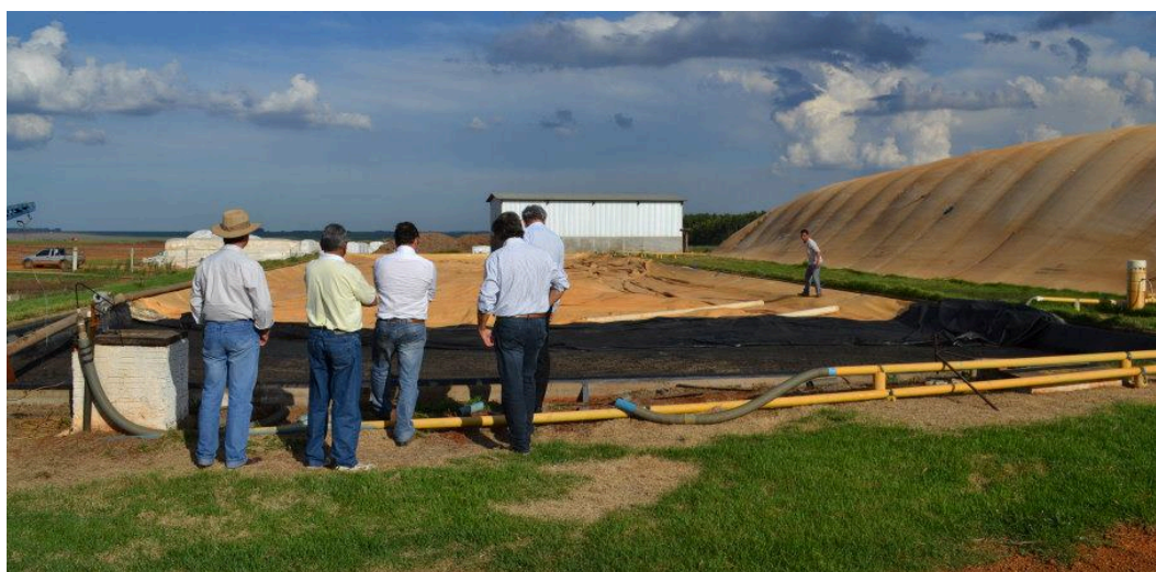
Figura 32 - Biodigestor modelo da Marinha Brasileira, ou Lagoa Coberta que está aberto em manutenção.
