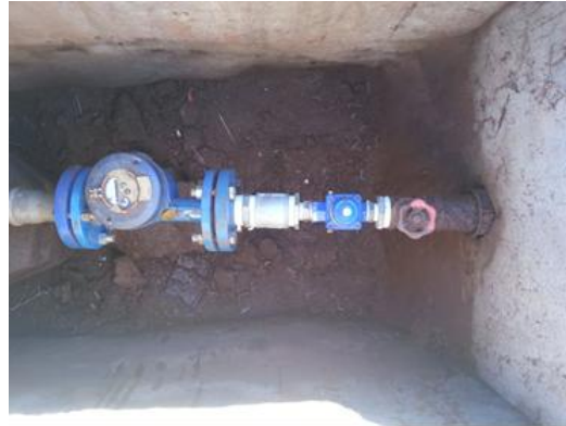
Figura 21 – Válvula Redutora de Pressão (VRP) instalada na entrada dos condomínios (ÁGUAS GUARIROBA, 2013).
