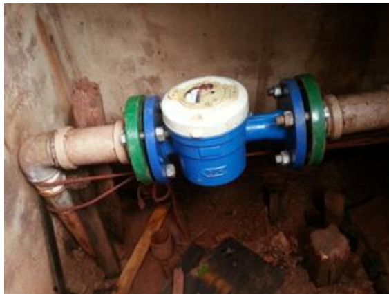
Figura 18 – Macromedidor instalado no condomínio Golden Gate (ÁGUAS GUARIROBA, 2013).
