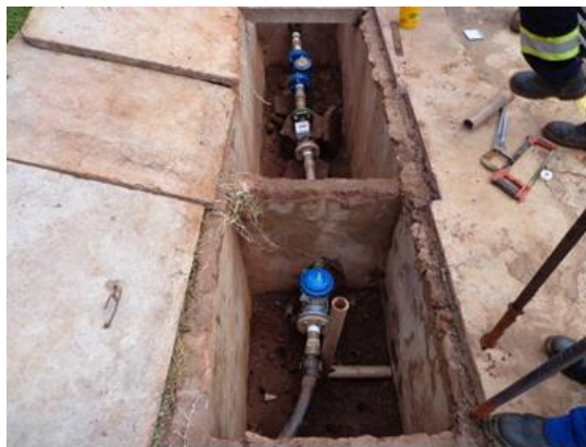
Figura 16 – Macromedidores em série instalados no condomínio Itayara (ÁGUAS GUARIROBA, 2013).
