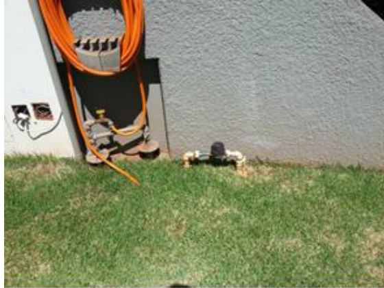
Figura 19 – Hidrômetro instalado no condomínio Golden Gate (ÁGUAS GUARIROBA, 2013).
