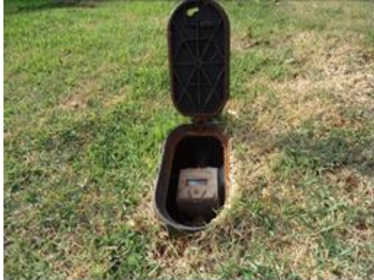
Figura 17 – Hidrômetro instalado no condomínio Itayara (ÁGUAS GUARIROBA, 2013).
