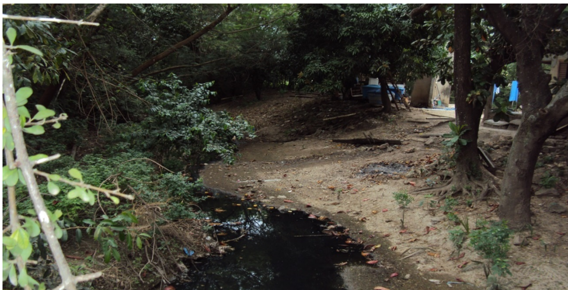
Figura 18: Esgoto Residencial em Canal de Drenagem
