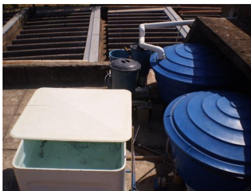
Figura 4.12 – Reservatórios utilizados no projeto.
