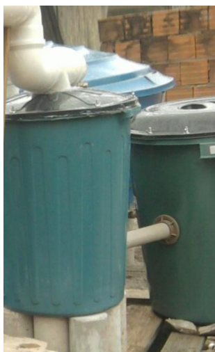
Figura 4.11 – Dispositivo first flush instalado
