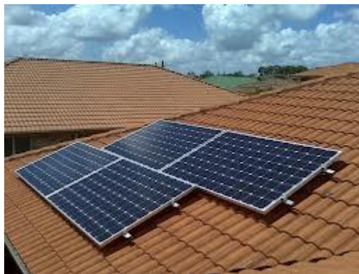
Figura 2.14: Painéis solares fotovoltaicos.
