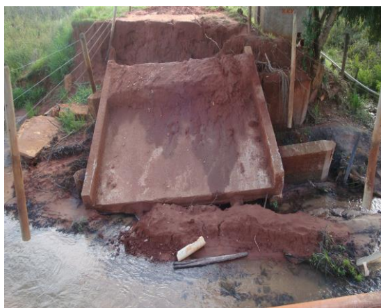
Ponto 10- Ponte caída na área do córrego
