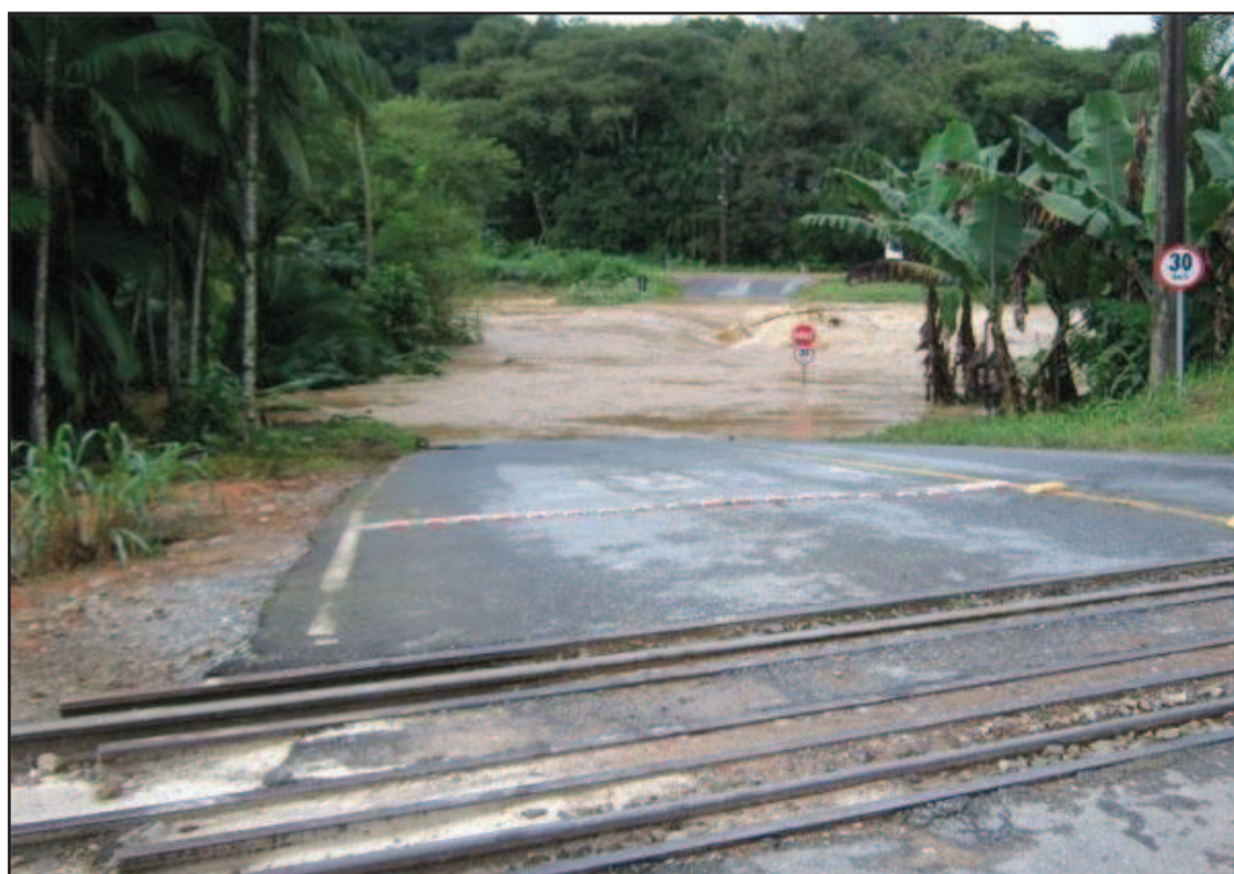
Figura 15: Bairro Barra do Rio Molha. Jaraguá do Sul – SC. Ponte Baixa, Rio Itapocu, queda de parte da ponte e inundação.
