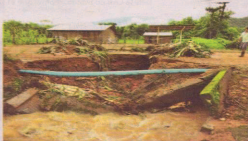
Enxurrada destrói galeria e parte de estrada no Bracinho
