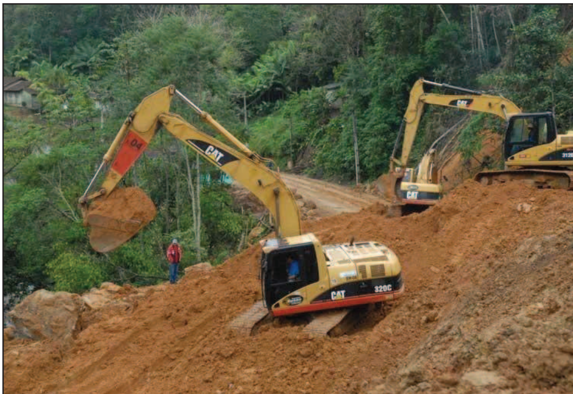
Figura 14: Bairro Barra do Rio Molha. Jaraguá do Sul – SC. Isolado após evento climático extremo em 2008
