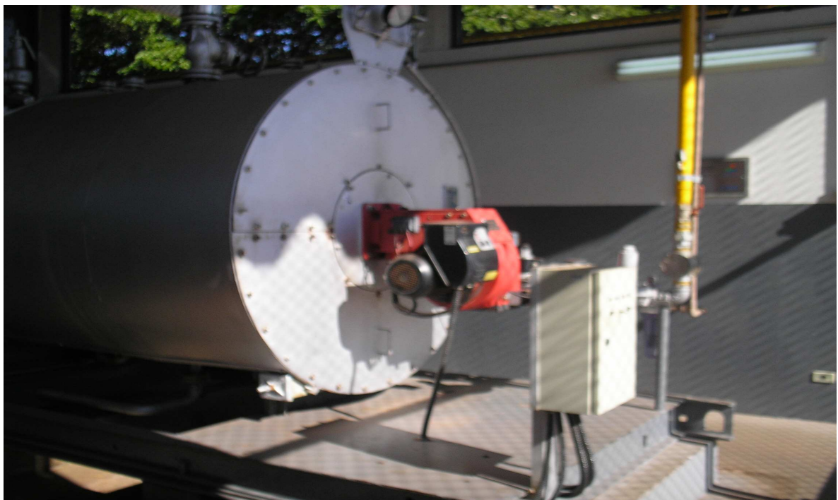
Figura 4.1 – Caldeira flamotubular instalada no Hospital Universitário da UFMS – Campo Grande – MS
