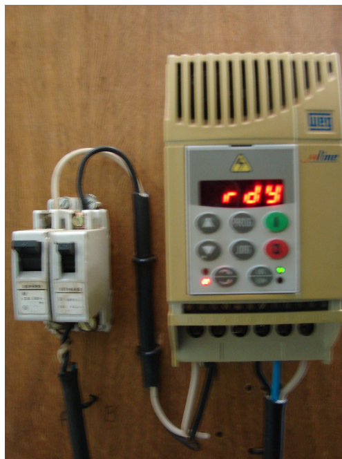
Figura 4.2. Inversor de frequência para controle de precisão do sistema de bombeamento.
