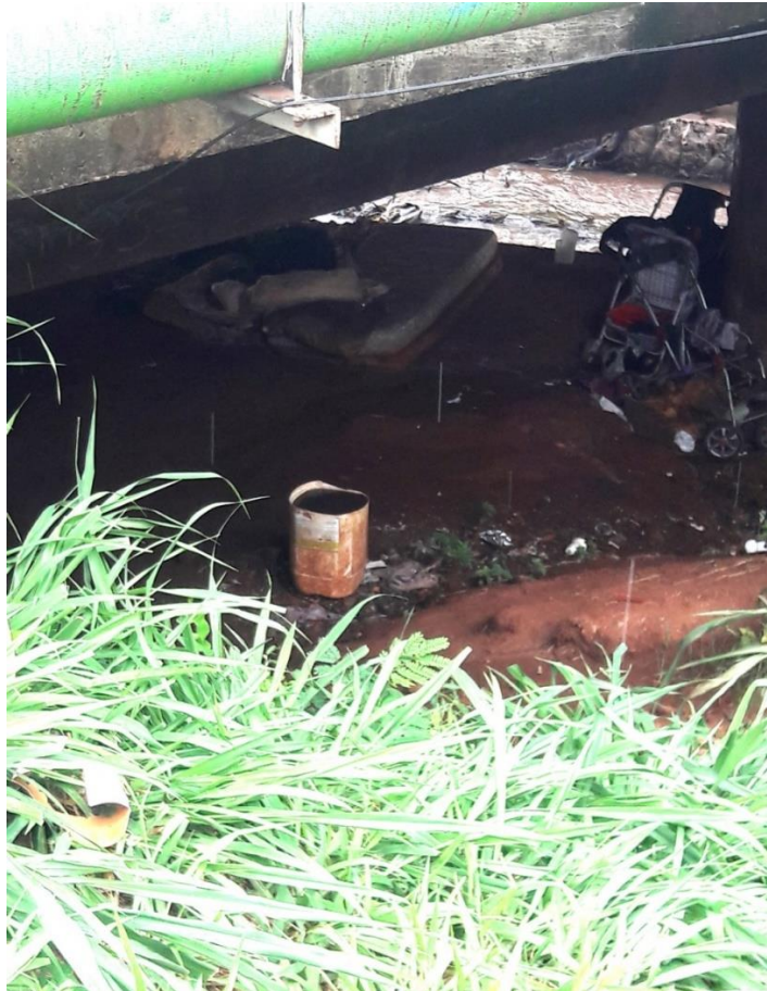
Figura 10. Colchão embaixo da ponte do rio Anhanduí que indica moradia da pessoas.
